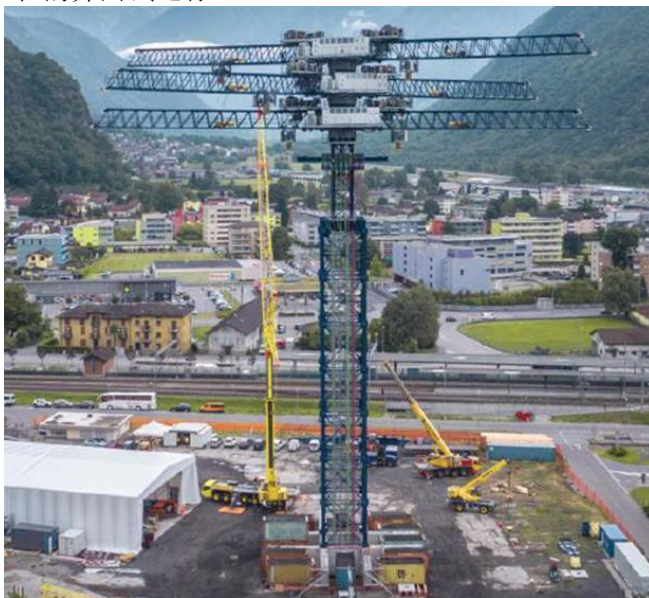
图 C.1 Energy Vault 公司重力储能商业示范工程
